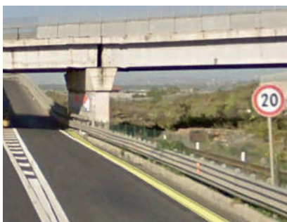
Fig. 1 Limite di velocità non coerente sulla rampa dello svincolo
