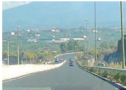
Fig. 2 Scarsa visibilità della segnaletica orizzontale sulla strada secondaria
