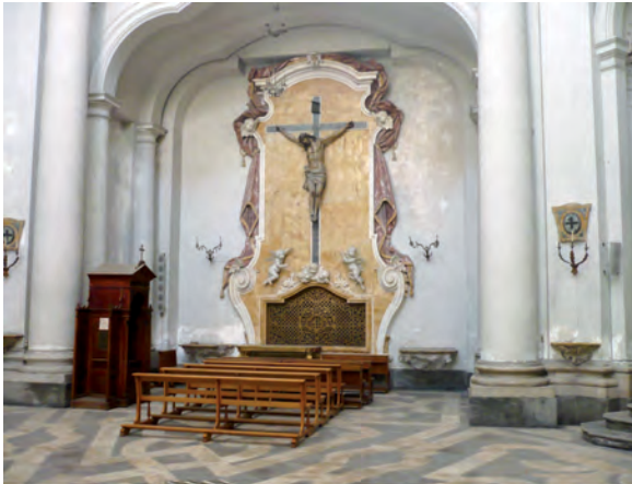
Fig. 8 Degrado delle superfici della cappella del Crocifisso
